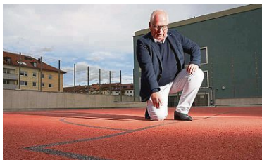
Gefährlich: Bei Feuchtigkeit treten Unebenheiten beim Sportplatzbelag auf.
